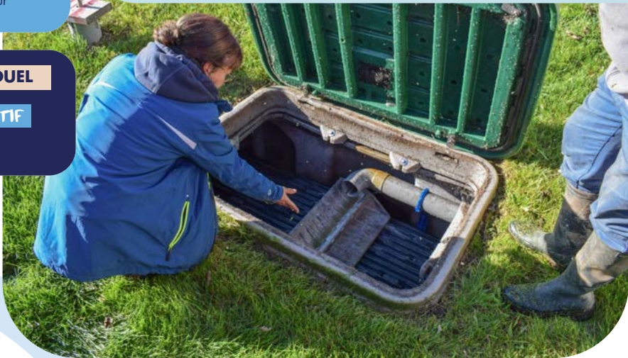
Visite d'un agent pour vérifier le bon fonctionnement du système ANC réhabilité. © An Dour
